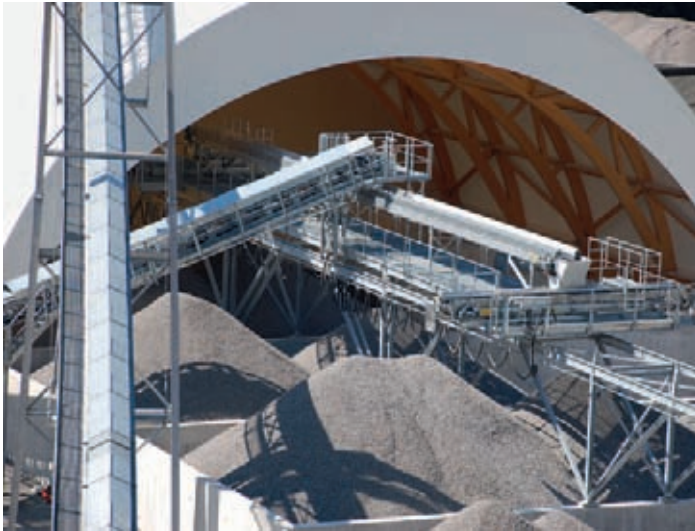
Die Lagerhalle für Brechsand und Splitt ist zur Gewährleistung einer hohen Qualität und zur Reduktion des Energieverbrauchs eingedeckt. Dazu sind die Wasch- und Depoteinrichtungen mit einem Membrandach überdeckt
