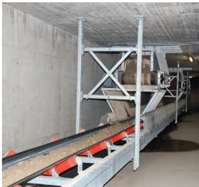
Alle Aufbereitungsschritte erfolgen direkt über die Förderanlagen von VHV. Die Bandanlagen weisen eine Gesamtlänge von über 200 m auf und führen auch durch einen 65 m langen Tunnel
