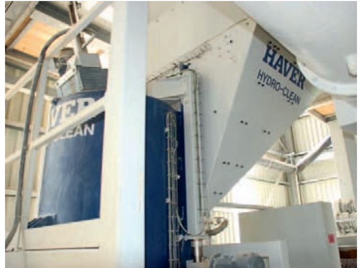
Im Waschprozess wird auch stark verschmutztes Material durch eine Haver-Hydro-Clean mit einem geringen Wasserbedarf sauber gereinigt und auf den Linearschwinger-Siebmaschinen normgerecht klassiert
