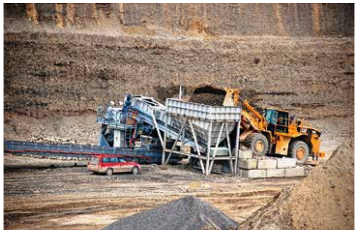
Die Aufgabestation mit der Vorabsiebung lässt sich in zwei Teilen mittels Radlader oder Hydraulikbagger im Abbaugelände beliebig platzieren und verschieben
