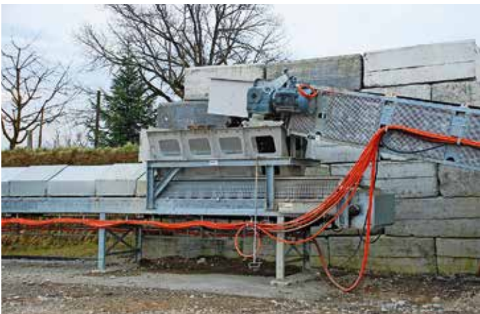
Die Bandförderanlage setzt sich aus zehn semimobilen Förderbändern, je einem Land-, Tunnel- und Werkarealband zusammen und wurde von der ASE Technik AG und dem Förderbandhersteller VHV errichtet
